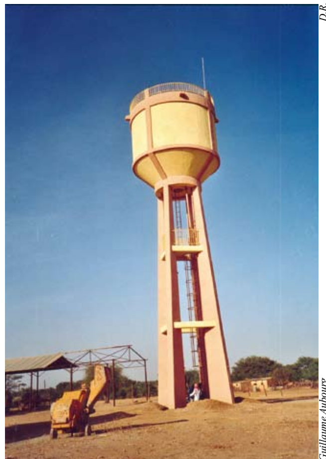
Réservoir d'un réseau d'alimentation en eau potable du village de Dioncoulané, Mali
